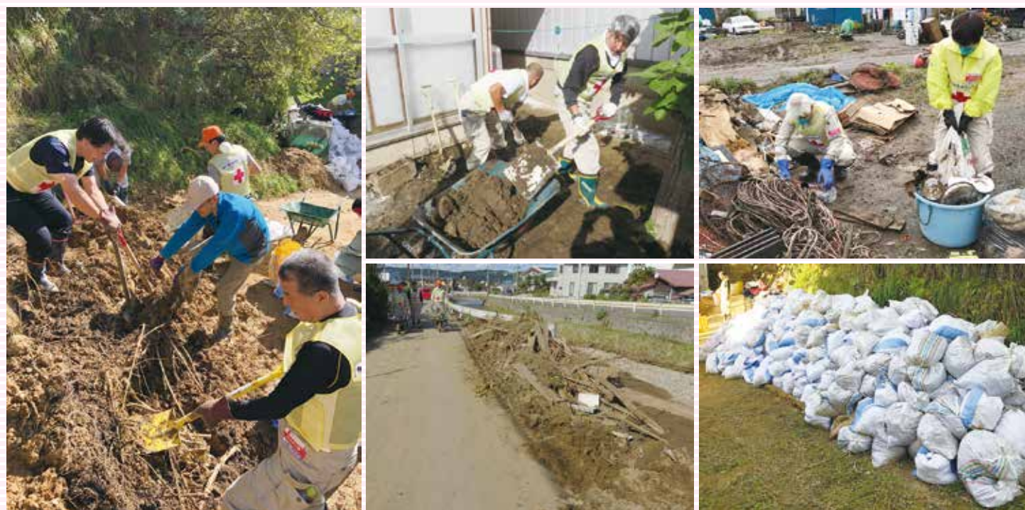
10/17 日赤岩手県支部にボランティアセンターを開設し、赤十字防災ボランティアを県内被災地へ派遣しました。久慈市、釜石市、田野畑村、宮古市、普代村、山田町で家屋の土砂撤去、瓦礫処理、炊き出しなど被災者のニーズにより活動しています。
